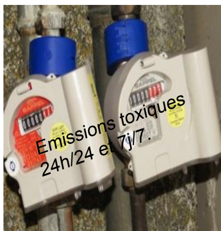
Compteurs d'eau à télérelevé
